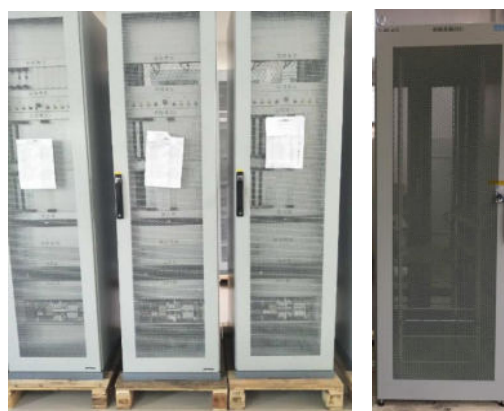
铁路区间综合监控
