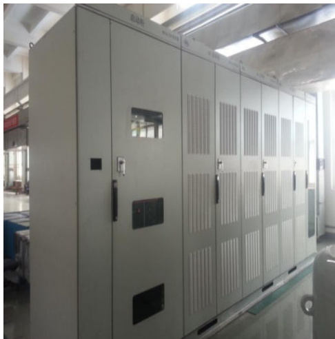
配电变电站 SVG系统
