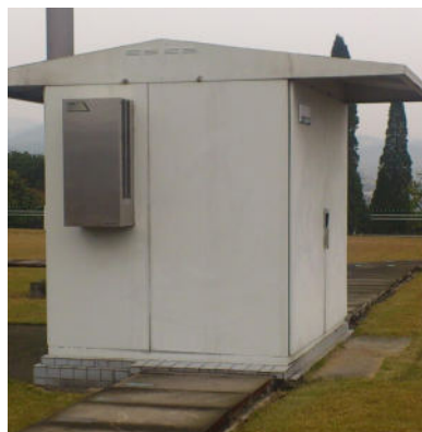
超高压直流换流站户外空调
