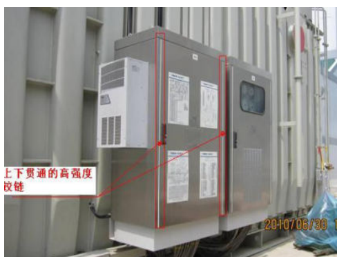
智能变电站变压器智能组件柜
