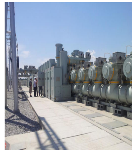
新疆750KV变电站
